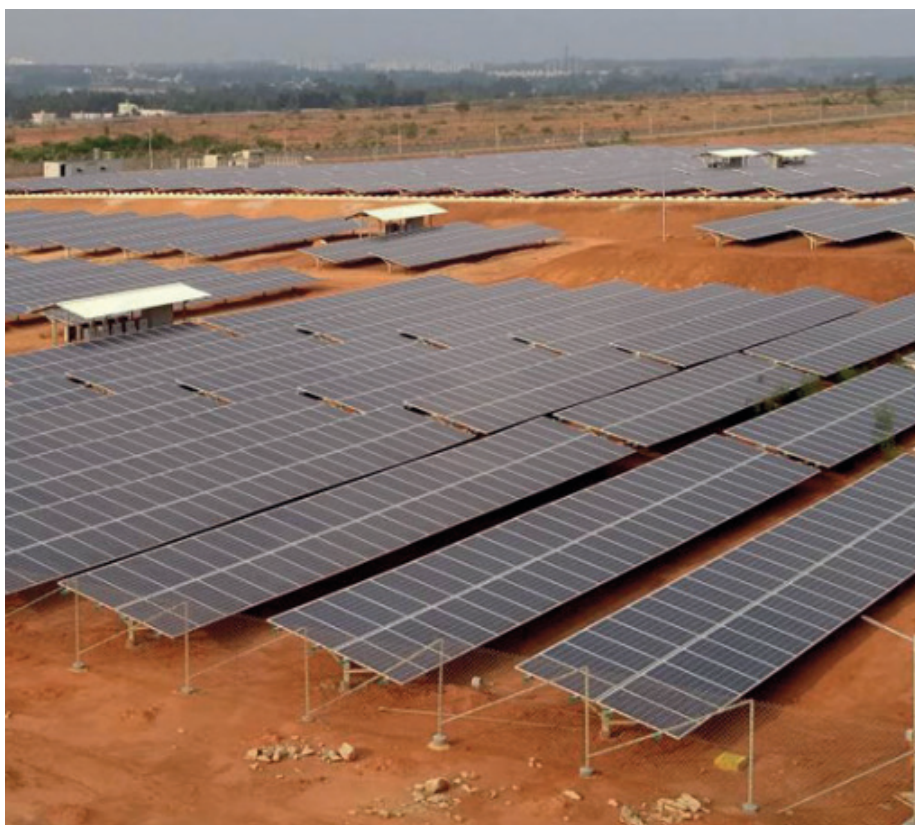
Solar mini grid
